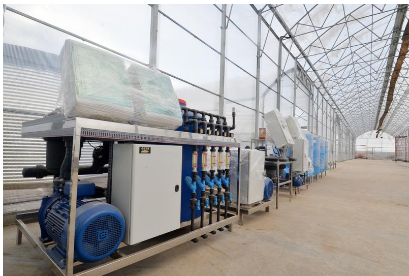
Рисунок 14 - Галерейное помещение с системой капельного автополива (Фото Павел Ворожцов)
