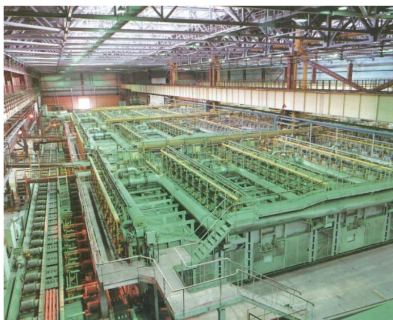
Рис. 3.44. Внешний вид термических печей отжига
